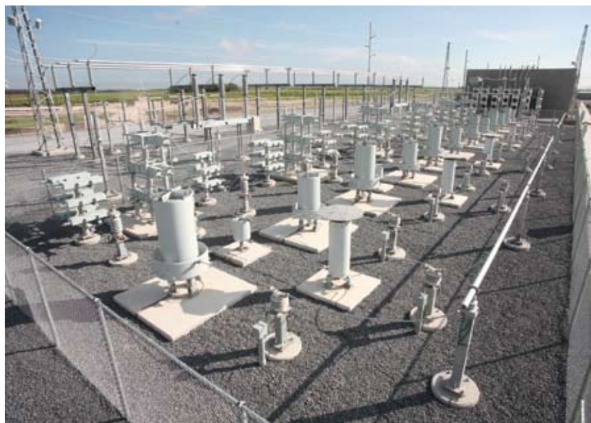
图3: 高压直流 (HVDC) 系统, 这样的 Sharyland HVDC 电站连接德州和墨西哥之间的电网, 实现了长距离输电。
